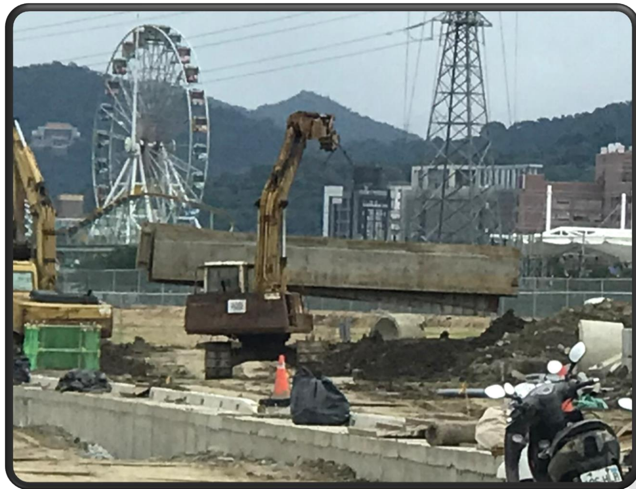
吊掛鋼板作業前未灑水 (缺失記點10點)
