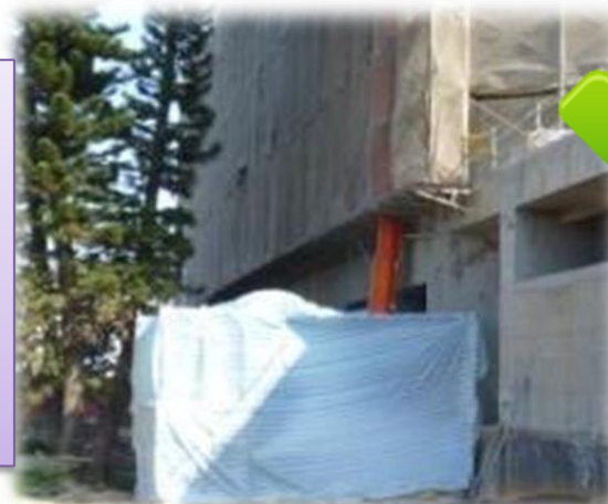
密閉輸送管道
