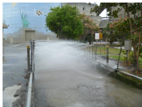
自動洗車設備
