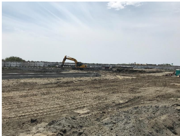
開挖作業前未灑水 (缺失記點10點)
