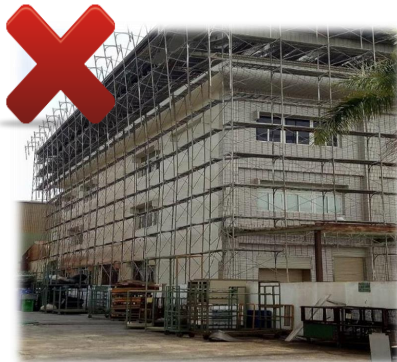
結構體無設置防制設施 (缺失記點10點)
