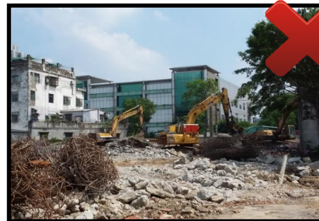
第一級營建工地未採行灑水及結構體包覆塵網(缺失記點10點)
