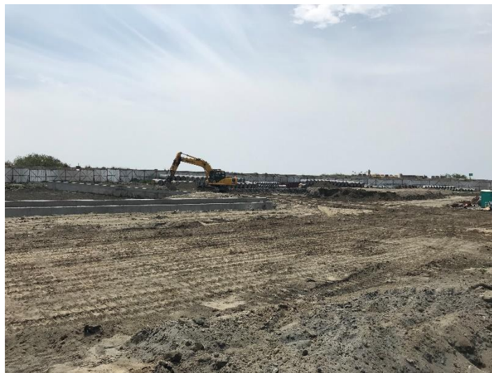
開挖作業前未灑水 (缺失記點10點)
