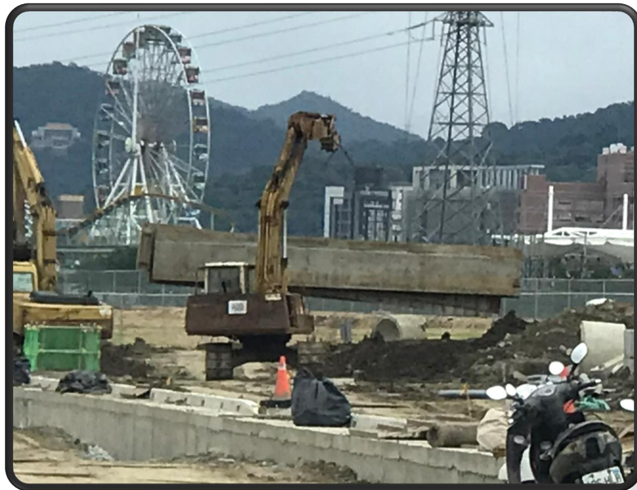
吊掛鋼板作業前未灑水 (缺失記點10點)
