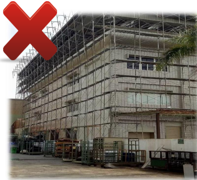
結構體無設置防制設施 (缺失記點10點)
