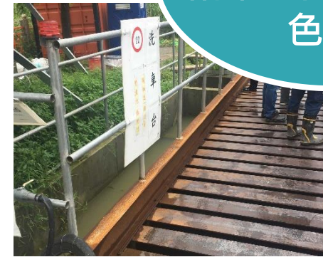
(2)廢水處理設備 (3)告示牌
