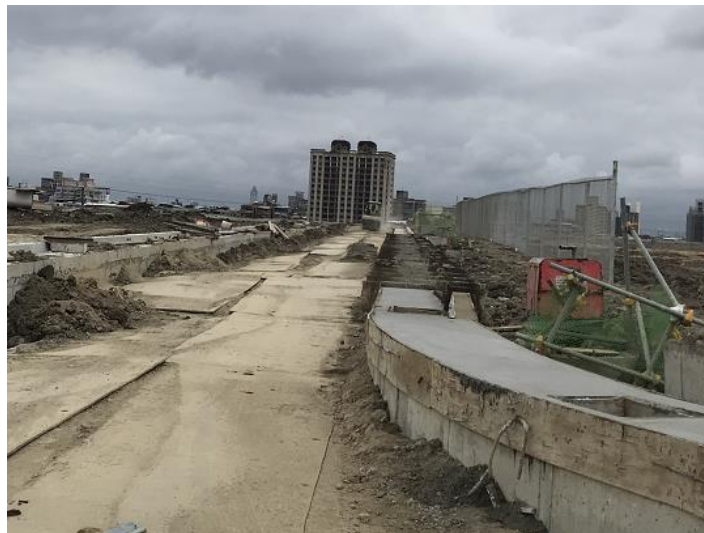
掃刷機作業前未灑水 (缺失記點10點)
