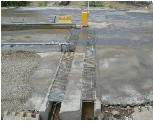
(G) 洗車廢水收集設施 (一)
