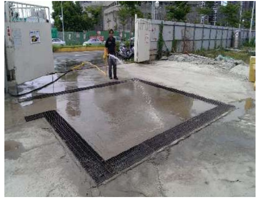
(H) 洗車廢水收集設施 (二)
